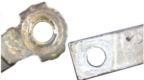
Рис. 1: Подключение заземления до очистки: слабый контакт
